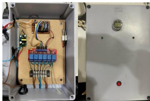
รูปที่ 5 กล่อง control box
